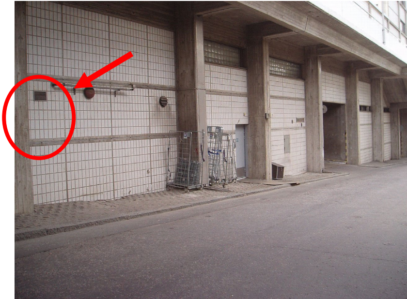
Kuva 6. Sprinklerlaitteiston hälytyskello on Asemamiehenkadun puolella.
