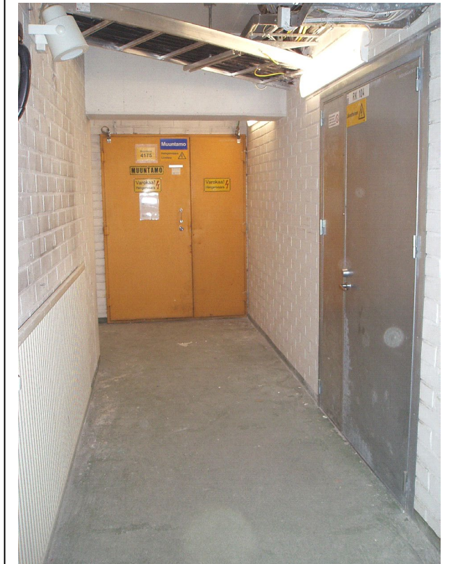
Kuva 9. Muuntamo käytävän perällä, sähköpääkeskus oikealla.
