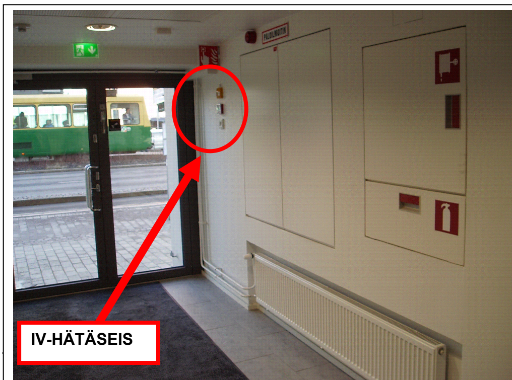
Kuva 7. IV- hätäseispainike on paloilmoittimen .. ..
