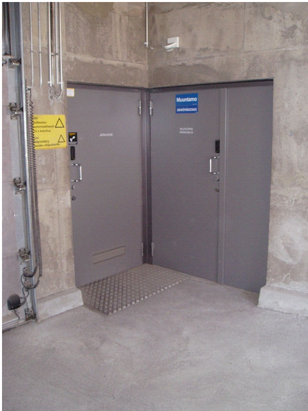
Kuva 8. Käynti muuntamoon ja sähköpääkeskukseen.
