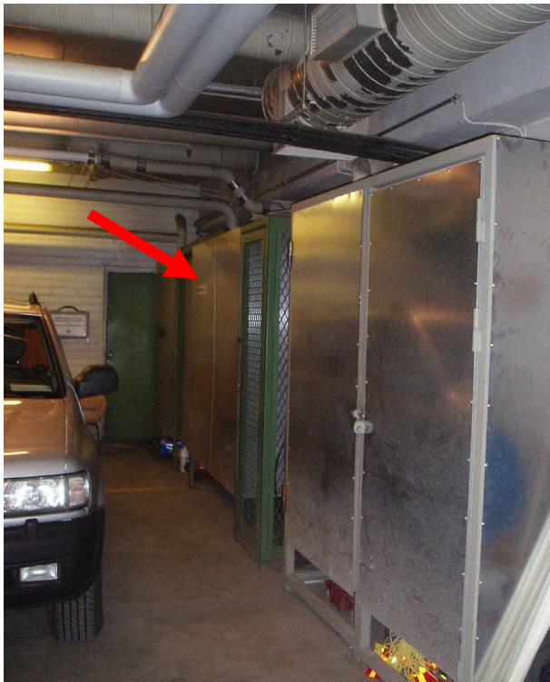
Kuva 4. Sprinklerkeskus on autohallissa pesupaikan vieressä.
