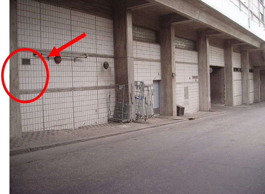
Kuva 6. Sprinklerlaitteiston hälytyskello on Asemamiehenkadun puolella.
