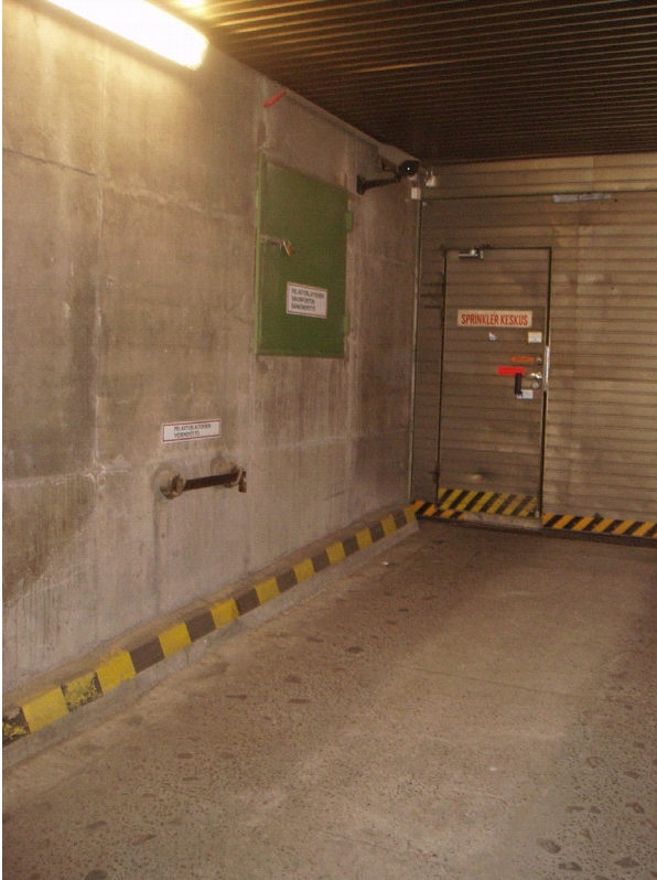
Kuva 3. Sprinklerkeskus on toisen kerroksen autohallissa. Luiskassa vasemmalla alhaalla sprinklerlaitteiston syöttöliittimet ja vihreän oven takana savunpoistolaitteiston virransyöttöliittimet.
