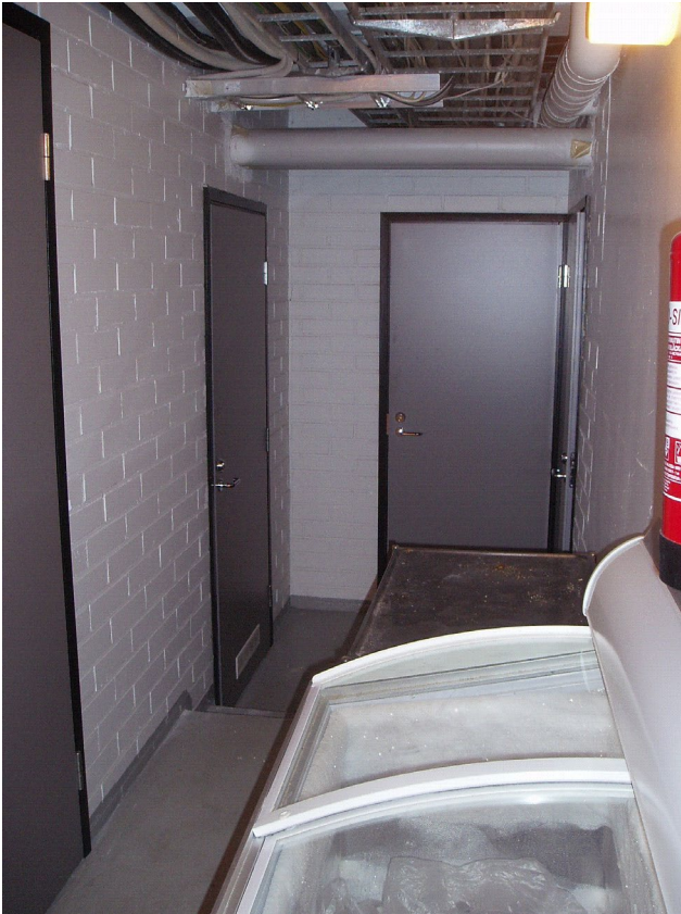
Kuva 10. Käynti lämmönjakohuoneeseen vasemmalla.
