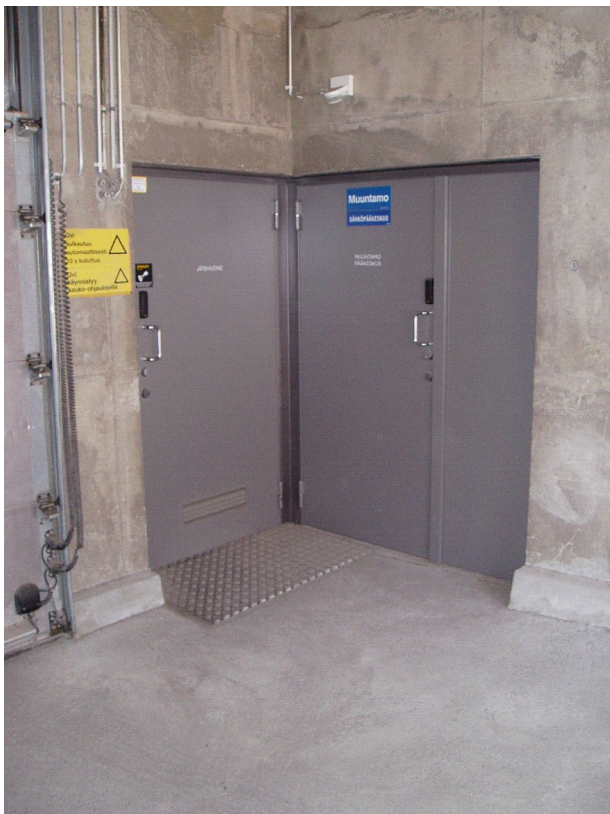
Kuva 8. Käynti muuntamoon ja sähköpääkeskukseen.
