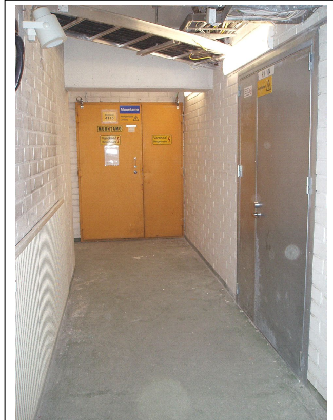
Kuva 9. Muuntamo käytävän perällä, sähköpääkeskus oikealla.
