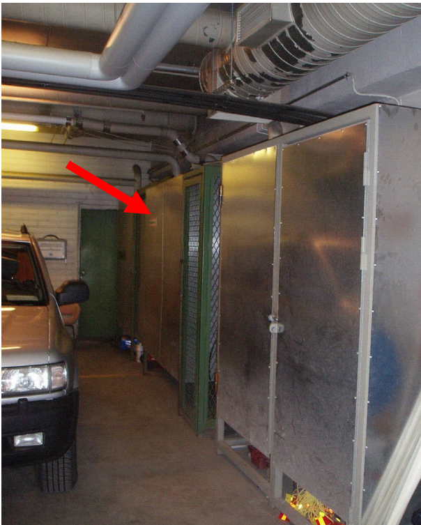
Kuva 4. Sprinklerkeskus on autohallissa pesupaikan vieressä.
